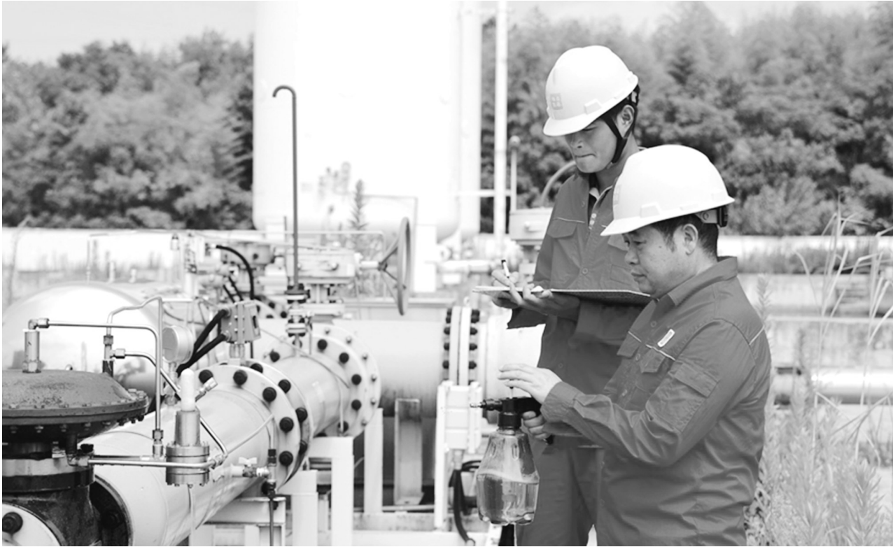
近日,在望江县旭日能源有限公司LNG(液化天然气)输配站,技术人员对燃气管道密封情况、管道压力值开展日常安检。
